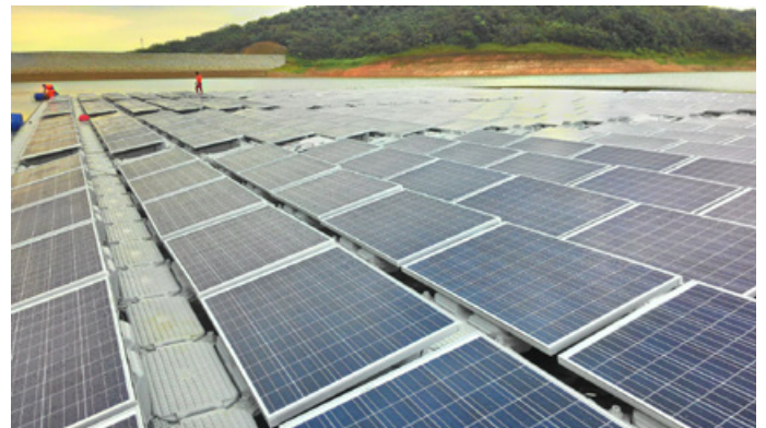
画像2: 432基のRECモジュールとCiel & Terre社のHydrelion®フロートを使用したマレーシアのスランゴール州サラクのスンガイラプにある108 kW フローティングPVシステム
